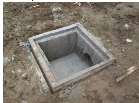
Sistema de drenaje alrededor de la casa
